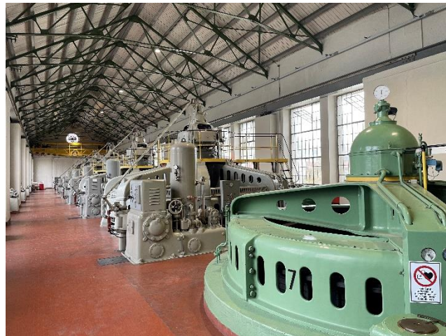
Sorgen für Lärm und Strom: Die Turbinen des Wasserkraftwerkes
